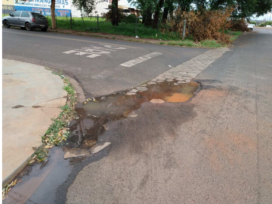
Foto 01: (situação do local)
