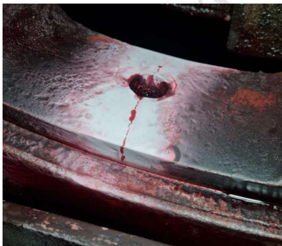
Fig. 3 – Trinca na roda – Teste com Líquido Penetrante.
