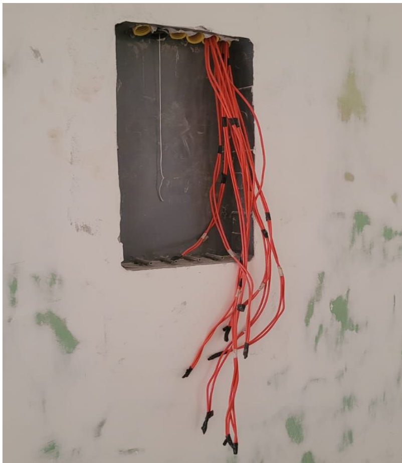
imagem 07 – Quadro de distribuição e tubo flexível
